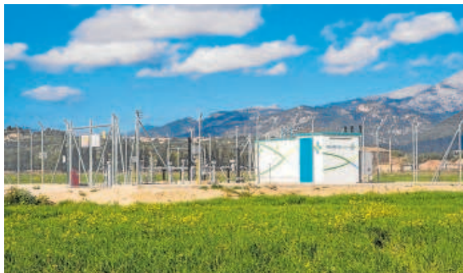
Posición de transporte de gas natural de Redexis
